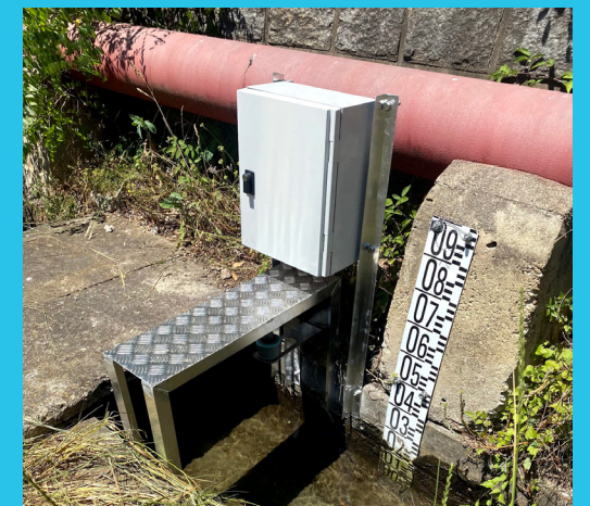
Compteur à télérelève installé par le Syndicat du Tech sur un canal gravitaire ©SMIGATA
