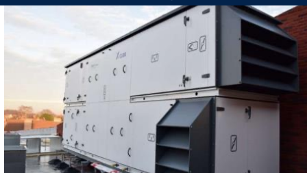
Remplacement de Centrale de Traitement d'Air Gain énergétique élec : 3 GWh/an Gain énergétique gaz : 2 GWh/an
