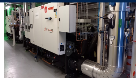
Groupes froids à récupération de chaleur Gain énergétique gaz : 9 GWh/an
