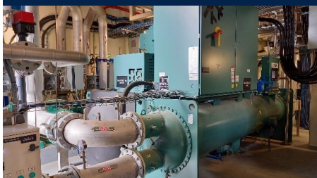
Changement d'un groupe froid par un groupe plus performant Gain énergétique : ~2 GWh/an
