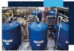
Unité de fabrication d'eau ultra pure aux facilities
