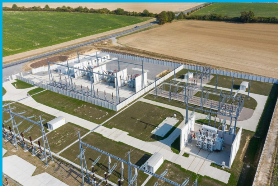
Figure 10. Photo « exemple » d'un poste de raccordement électrique
