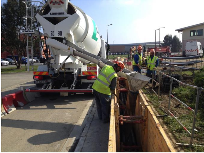
En fourreaux PVC (réseaux denses)
