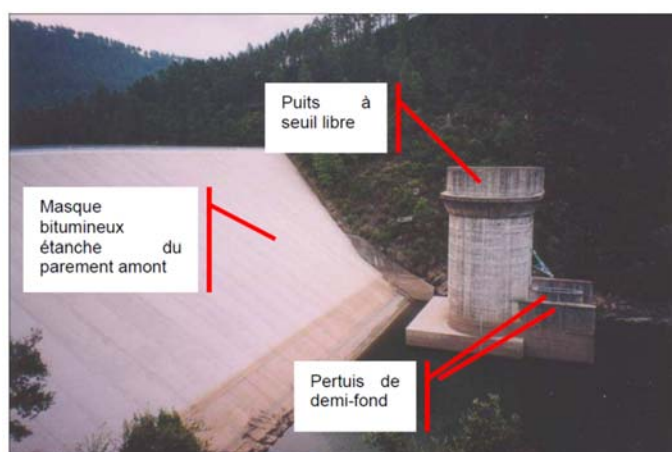
Photo 1 : Vue des parements amont et de la tulipe du barrage de Sainte Cécile
